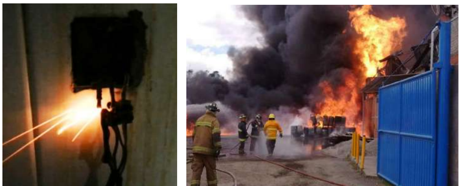
Figs. Fuego originado por un chispazo en un transformador eléctrico desembocó en un incendio de una destilería de combustible. El fuego se propagó por el combustible líquido, aún siendo originado por otra causa.
