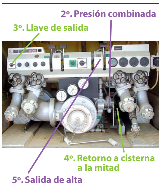
Figura nº 43 Operaciones sobre la bomba
