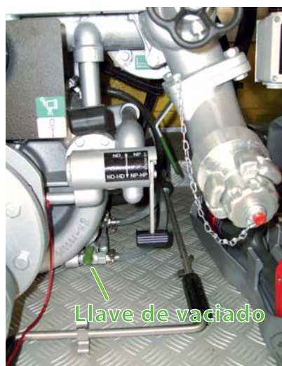
Figura nº 47 Llaves de vaciado
