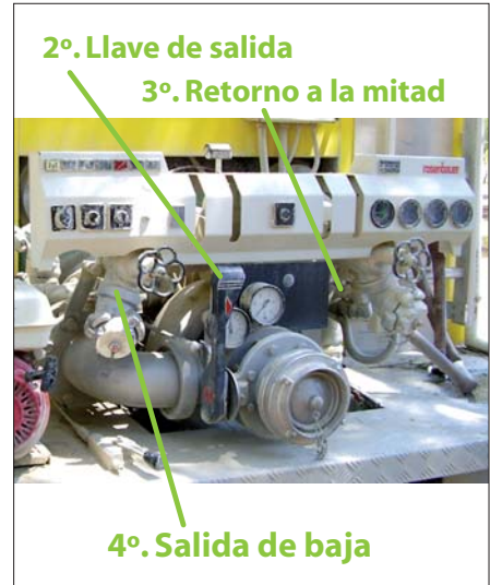
Figura nº 52 Operaciones sobre la bomba
