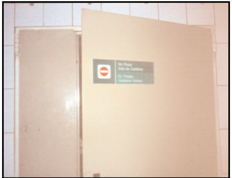
Puerta resistente al fuego compartiendo una sala de calderas
