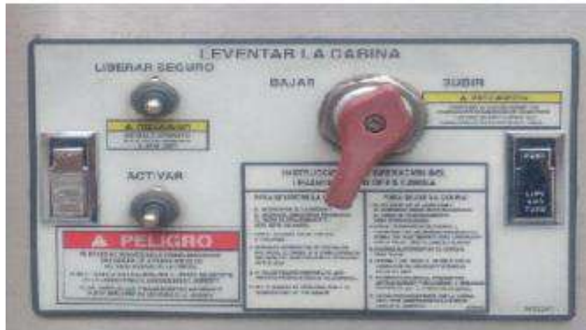
Figura 3. Interruptor Levante de Cabina.
