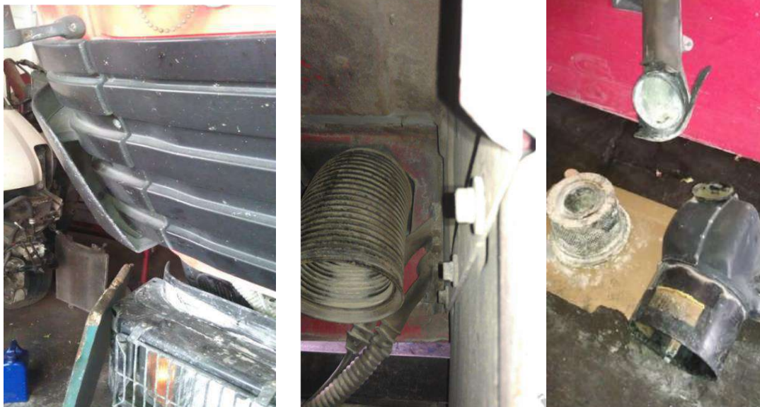
Ilustración 17, 18 y 19. Entrada de aire a los filtros en diferentes autobombas y filtro quemado en una de ellas. Fuente: R. Quílez.
