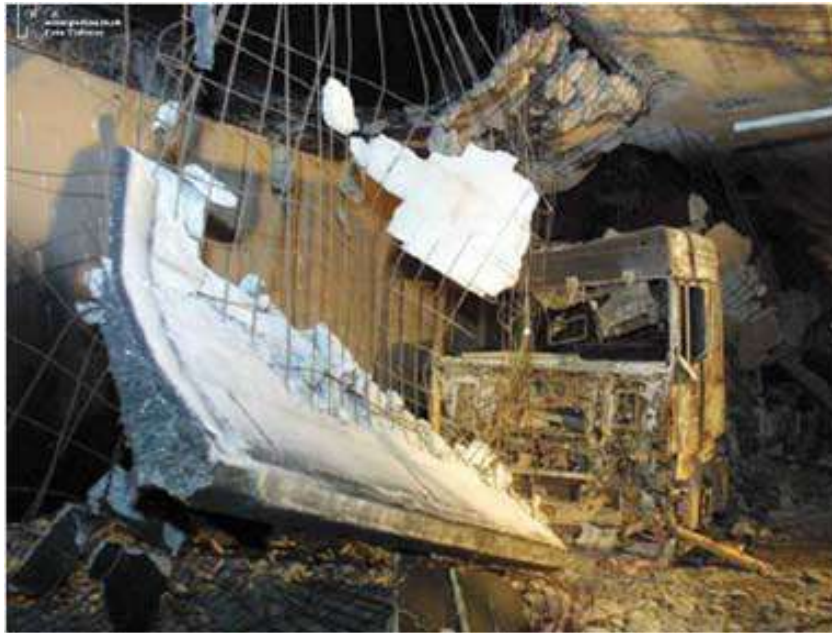
Figura 1 : Hundimiento del falso techo en el incendio del túnel de San Gotardo (2001)
