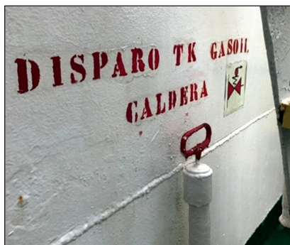
Disparo en la cubierta del tanque de gas-oil de la caldera.
