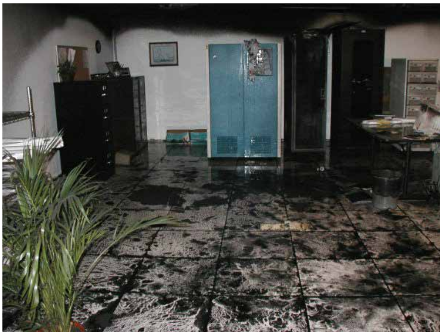
Extinción con rociadores, notar el estado en que quedan las instalaciones luego del apague
