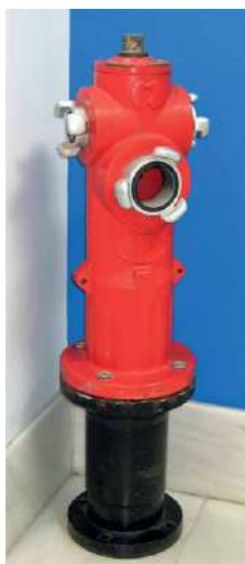
Hidrante de columna.
