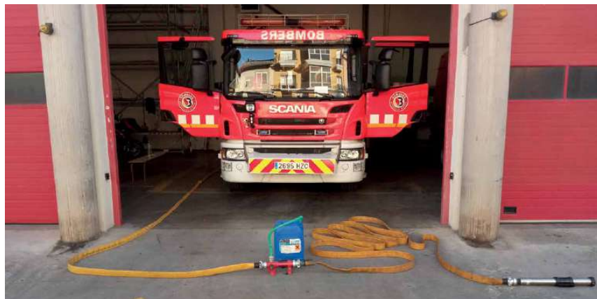
Instalación espuma baja expansión, con premezclador y garrafa.
