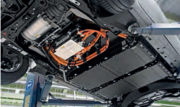
Cableado naranja en los bajos
