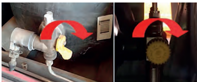
Llaves de cierre manual depósito de GNC
