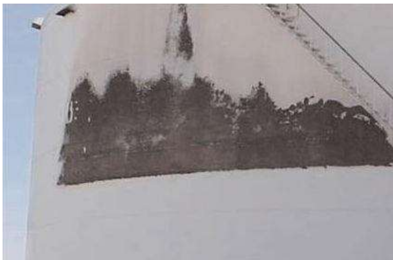
Marca de nivel de fuego en el tanque
