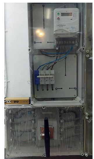
Fusibles en cuarto de contadores.
