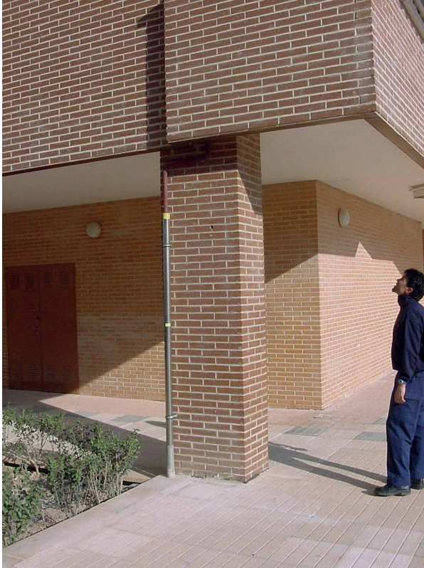
Llave de montante, al pie del montante, de una urbanización de torres independientes.
