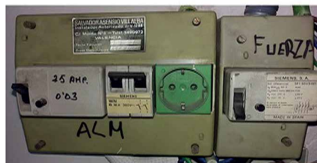
Distintos cuadros de protección eléctrica.
