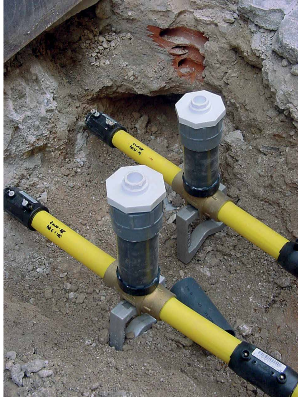
Llaves de corte enterradas de dos acometidas.
