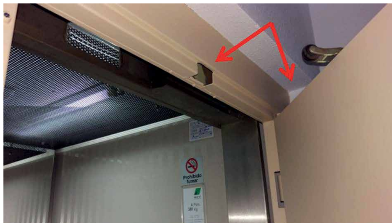
Llave en alojamiento puerta de planta.
