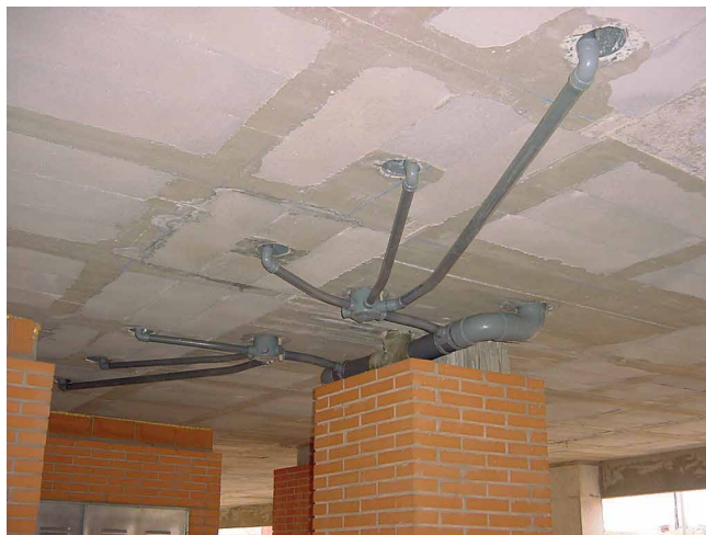
Red Pequeña evacuación.
