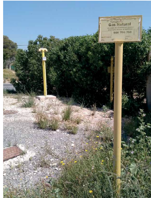
Hito de gaseoducto y sifón de ventilación.
