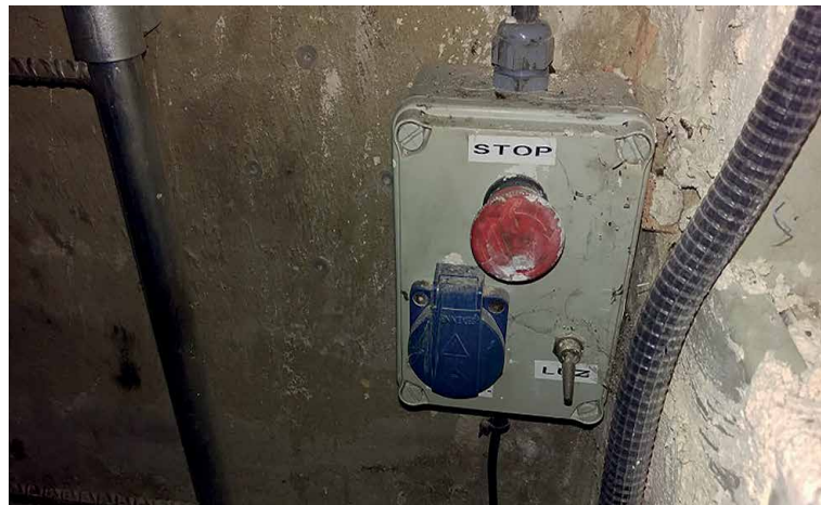
El pulsador de seguridad STOP (seta).
