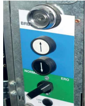
Maniobra eléctrica de socorro.
