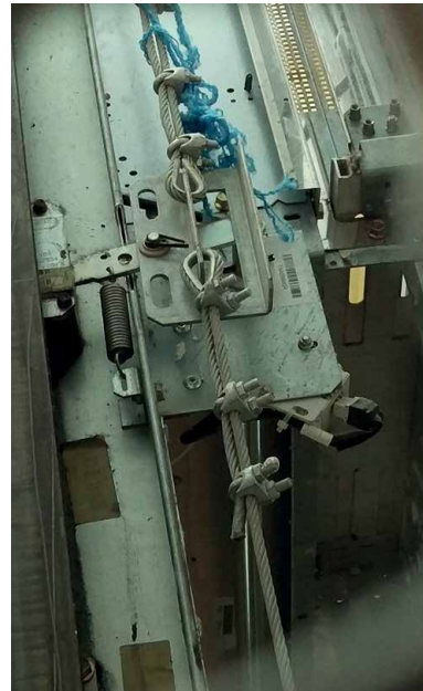
Anclaje del paracaídas al cable del limitador.
