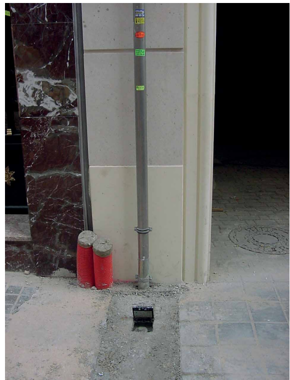
Tubería alojada en vaina.
