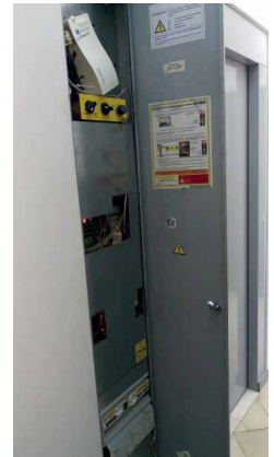
Acceso a cuadro de maniobra.
