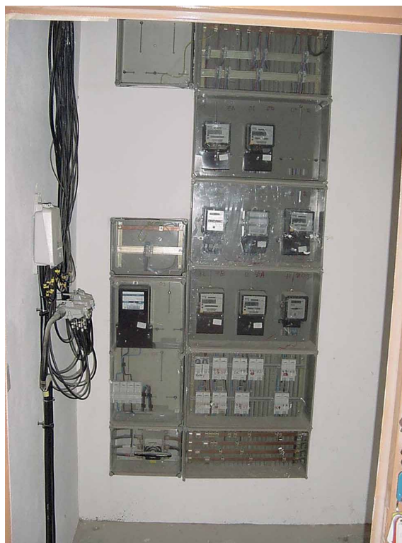
Centralización de contadores.
