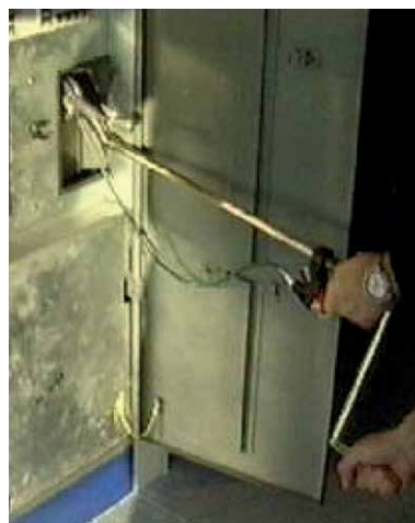
Maniobra manual de emergencia sin sala de máquinas
