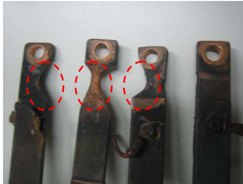
Fotografía 6.25 – El borne de la derecha muestra la geometría inicial de los bornes mientras que en los tres bornes de la izquierda se marcan (en rojo) los efectos destructivos del arco eléctrico.
