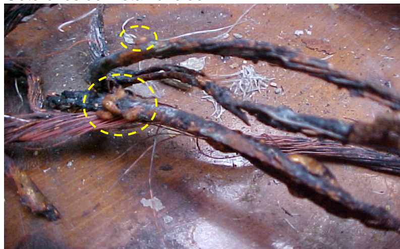
Fotografía 6.6 – La elevada carga térmica presente en el escenario del incendio provocó la fusión parcial del cobre. Obsérvense los goterones de cobre (resaltados en amarillo) generados por su fusión parcial.
