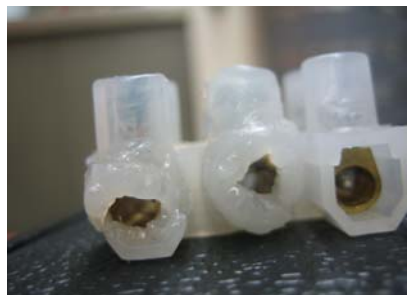
Fotografía 6.12 – Deformación causada en una regleta de plástico como consecuencia de un defecto de presión en la fijación de los conductores
