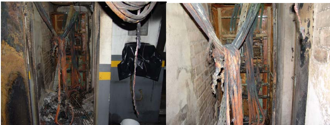
Fotografías 6.26 y 6.27 – Destrucción total del cuadro eléctrico, mangueras de cobre y revestimientos de los paramentos del compartimento donde se produjo un arco eléctrico
