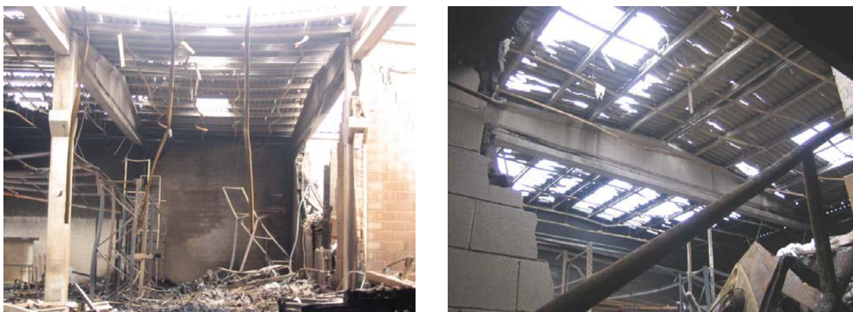
Fotografías 5.1 y 5.2 – Daños ocasionados por el incendio ocurrido en una empresa de S. Hilari Sacalm
