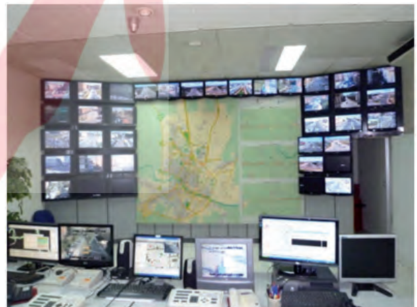
Imagen 17. Sala de control de tráfico
