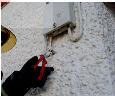
Imagen 38. Retirada de fusible de la CGP y corte de cable de acometida
