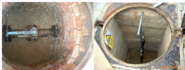
Imagen 6. Válvulas de corte en media presión A y B (Gas Natural)
