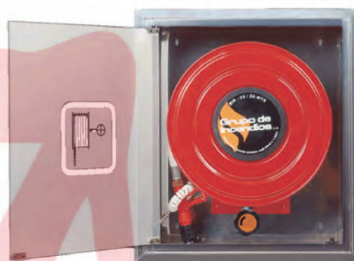
Imagen 6. Boca de incendio equipada con manguera semirrígida
