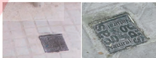
Imagen 8. Acometida a edificio
