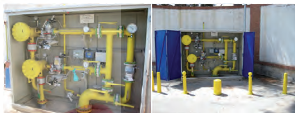
Imagen 7. Estación de regulación y medida (Gas Natural)
