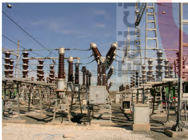
Imagen 31. Transformador de potencia (imagen superior) y transformadores de intensidad e interruptores de corte (imagen inferior)
