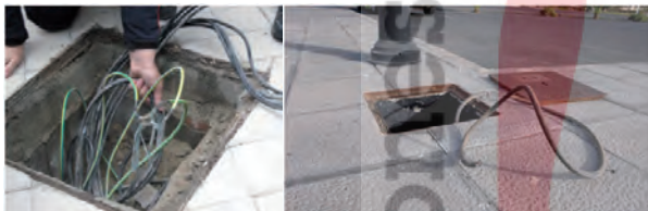
Imagen 15. Arqueta de alumbrado junto a farola
