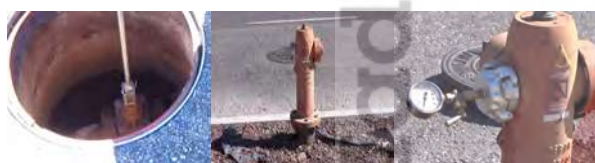
Imagen 20. Procedimiento para la revisión de hidrantes
