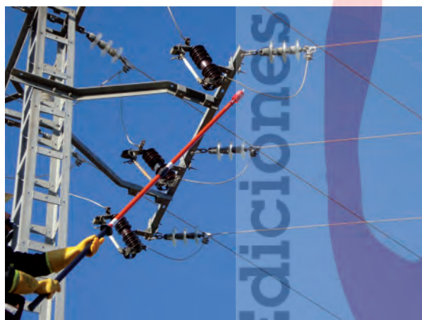
Imagen 27. Comprobación de tensión en alta tensión, utilizando dos elementos de aislamiento (guantes y pértiga) y detector de AT.
