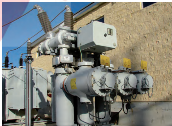
Imagen 29. Corte visible (arriba) con seccionador fusible abierto. Corte efectivo (abajo), aparamenta blindada SF 6
