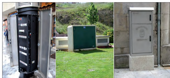
Imagen 14. Cuadro de alumbrado en exteriores
