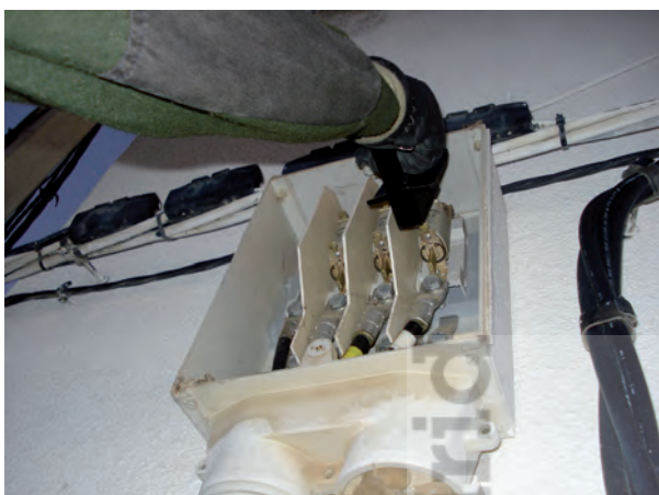
Imagen 36. Retirada de fusibles en CGP
