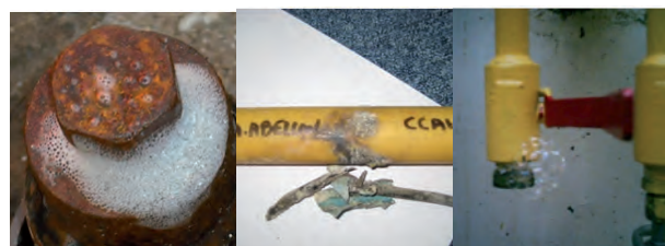
Imagen 4. Detección de fuga en la red de gas natural mediante agua jabonosa (Gas Natural)
