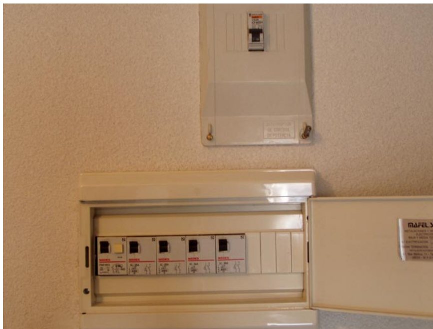
Figura: ICP, en la parte superior, con el CGD en la parte inferior. El ICP va precintado.
