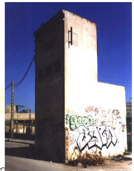
Fig. 10: Centro de transformación de superficie
