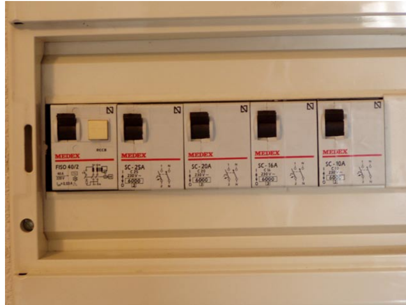
Figura: CGD. A la izquierda está el diferencial con su inconfundible botón de test. A la derecha hay 4 PIA's para los circuitos de: horno, lavadora y termo, tomas de corriente e iluminación.
