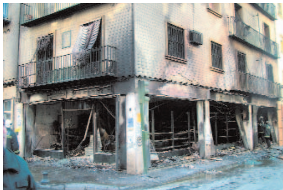
Edificio con afectación en planta baja visible desde el exterior
