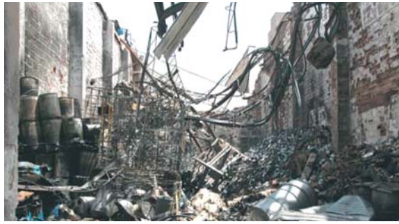
Colapso de una cubierta formada por cerchas metálicas no protegidas. Los muros colindantes disponían de una buena resistencia al fuego
