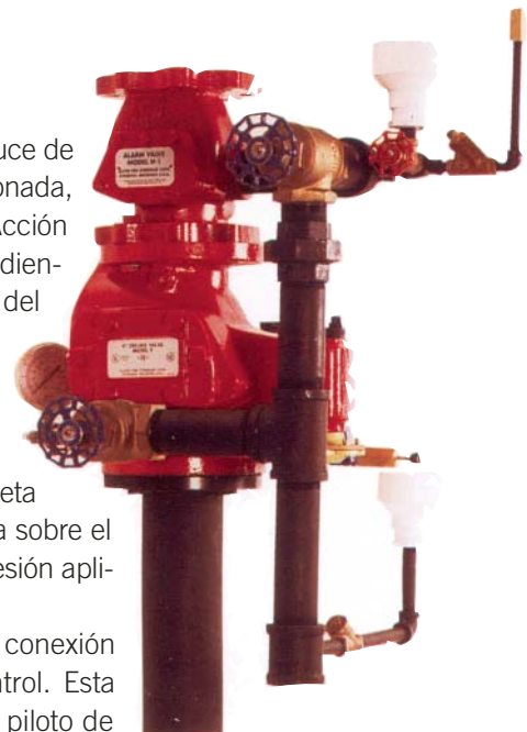
Valvula de accion previa
