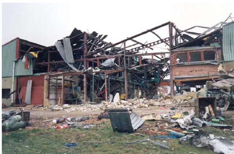
Los efectos de las detonaciones pueden provocar daños estructurales irrecuperables.
