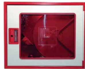
Boca de incendio equipada de 45 mm
