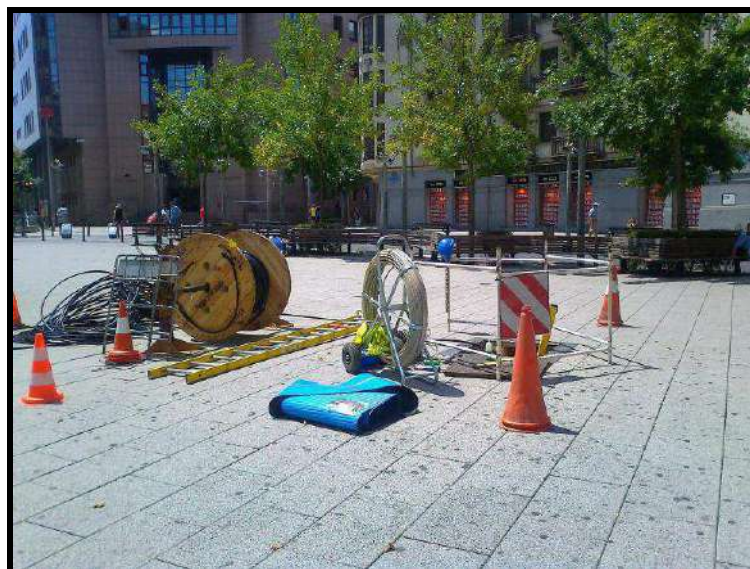
Balizamiento para evitar la caída de personas al interior
