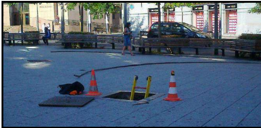
Recinto confinado deficientemente señalizado
