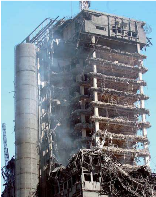
Foto 4.- La estructura de hormigón del Edificio Windsor tras resistir la acción del fuego.
