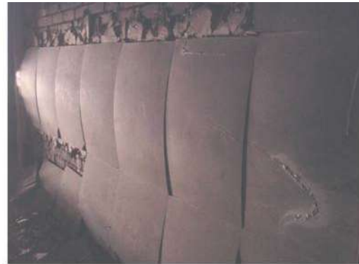
Foto 5, 6, 7 y 8.- Interior del Edificio Windsor después del incendio.
