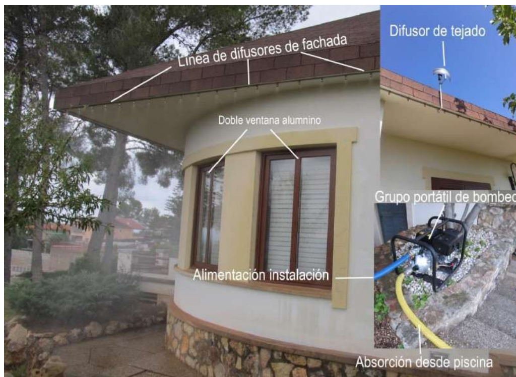
Imagen 96. Sistema de Defensa SIDEINFO doméstico. Difusores fachada y tejado conectados a piscina de vivienda en área de Interfaz Urbano-Forestal. Fuente: Medi XXI GSA.
