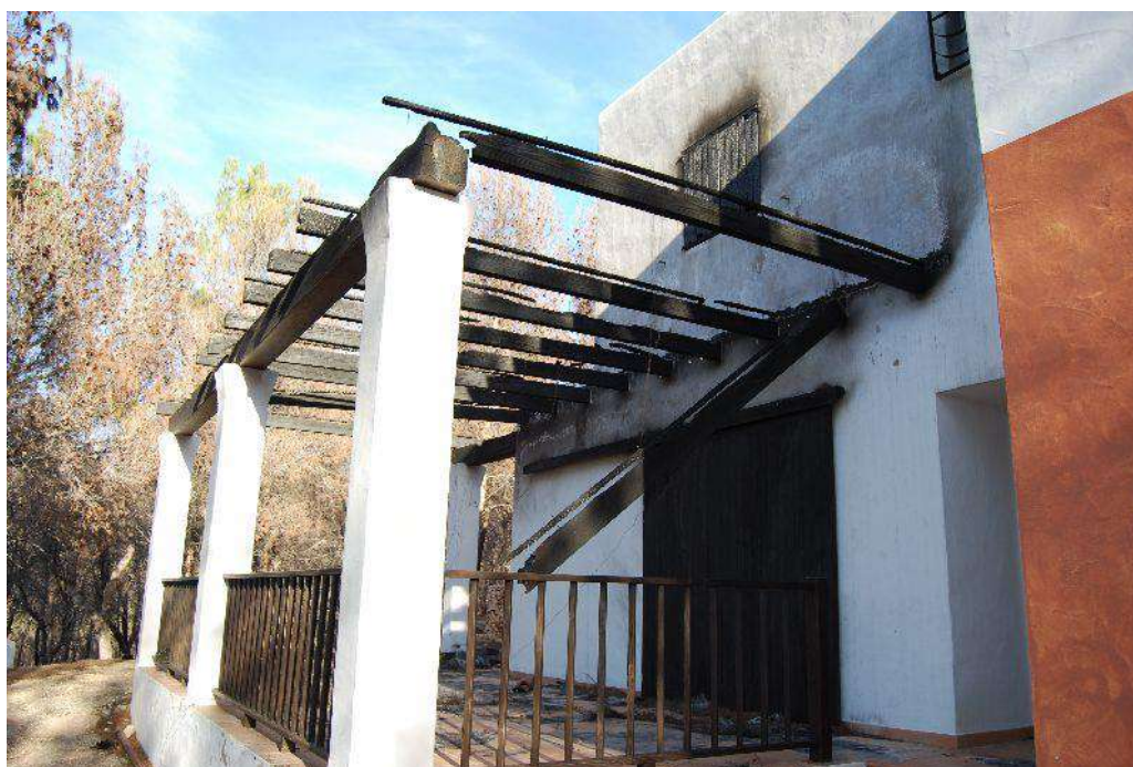
Imagen 69. Continuidad de las llamas del exterior al interior de la vivienda Benirrás, Ibiza 2010 Fuente: Caballero, D.
