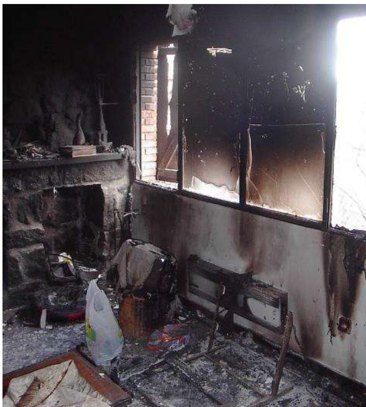
Imagen 70. Continuidad de las llamas del exterior al interior de la vivienda por el acristalamiento, punto débil de la vivienda (Fuente: Caballero, D.)
