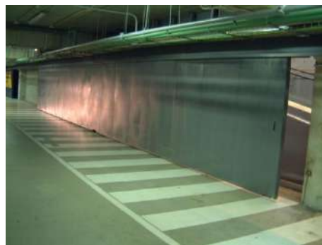
Figura 16. Puerta cortafuego corredera
