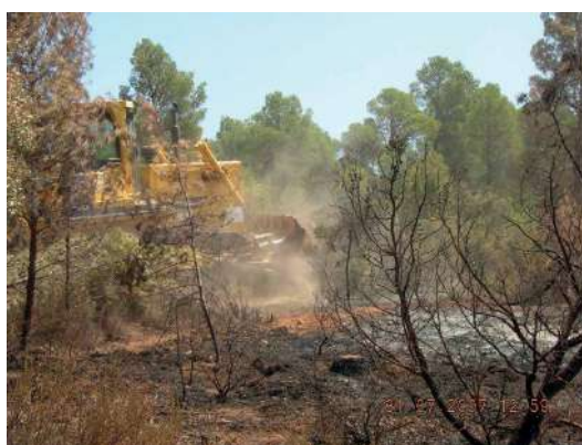
D6 trabajando en el cierre de perímetro del incendio de Ayora de 2007. (Fuente. Raúl Quílez).
