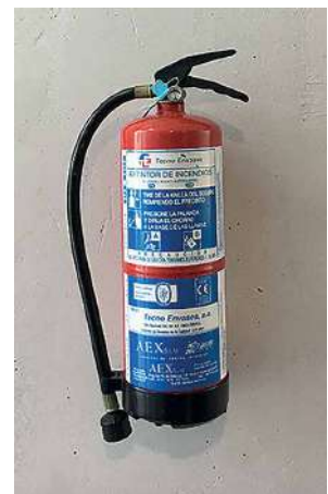
Extintor. (Fuente. Propia).
