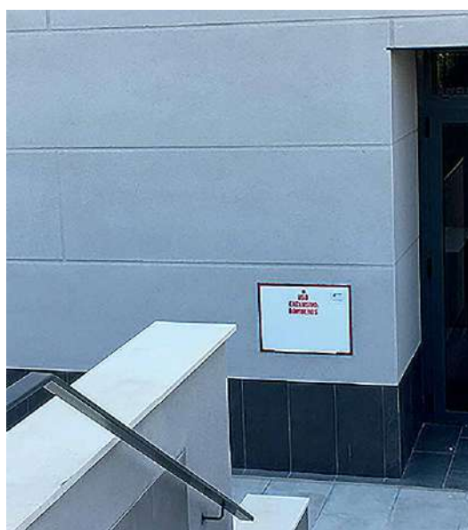
Toma alimentación en fachada. (Fuente propia).
