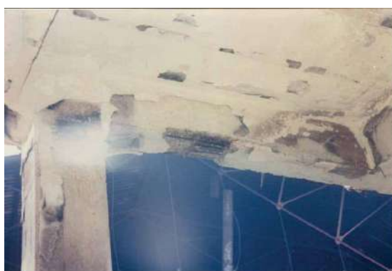
Desconchamientos de viga.
