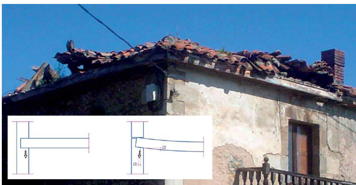
Empuje por deformación de viga.
