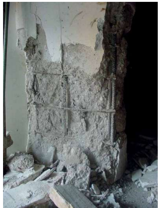
Fallo de pilar a compresión.
