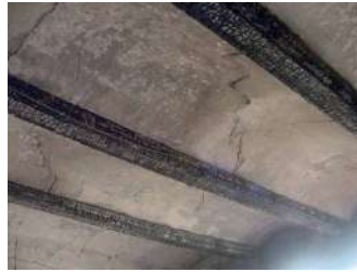
Viguetas de madera afectadas por incendio.
