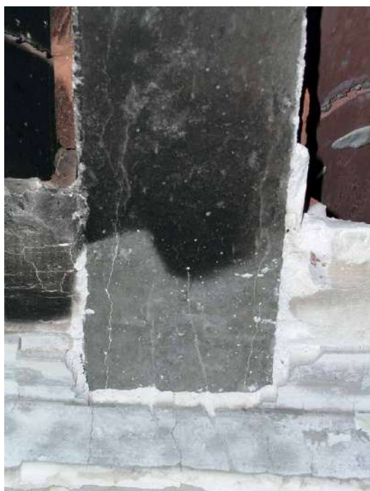
Detalle fisuración de la vigüeta.
