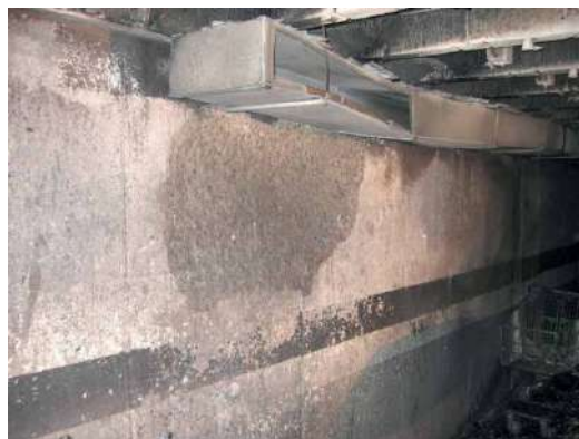
Spalling producido en el muro de hormigón armado.
