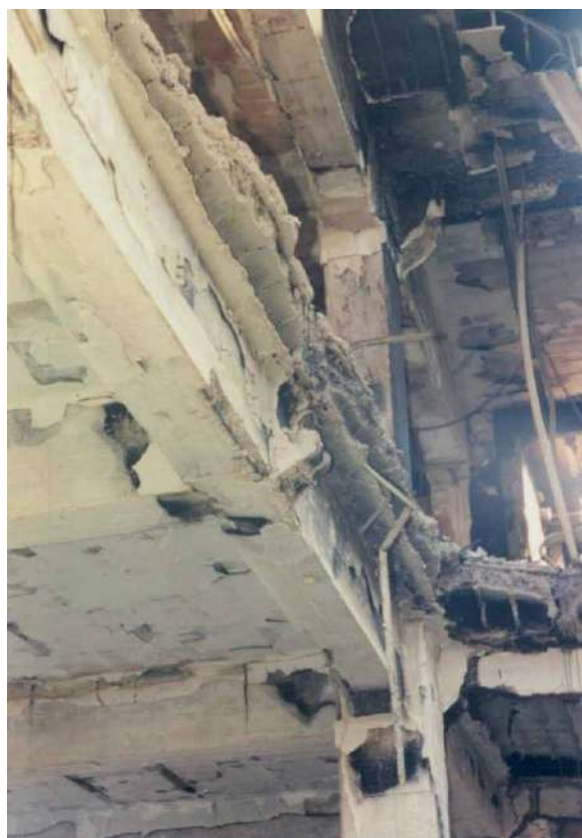
Colapso de forjado por fallo de ménsula.
