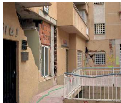
Daños en elementos de cerramiento.
