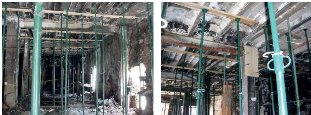
Incendio con estructura de acero.
