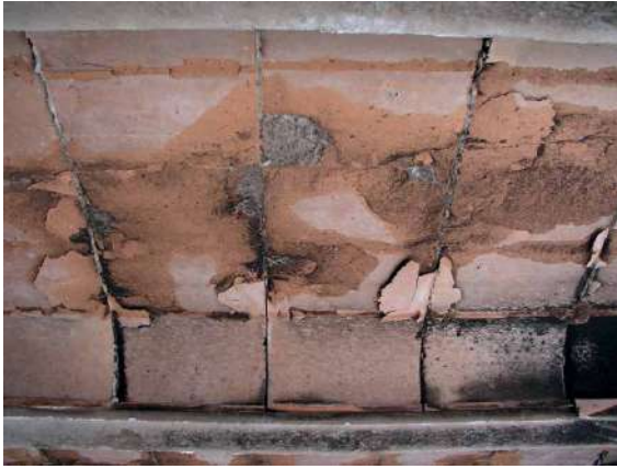
Detalle forjado afectado por incendio.
