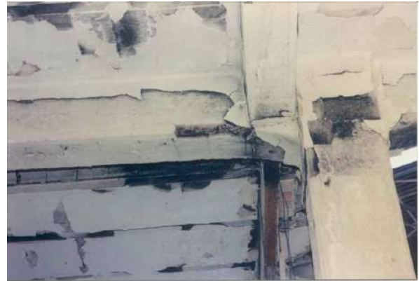
Forjado afectado por incendio.
