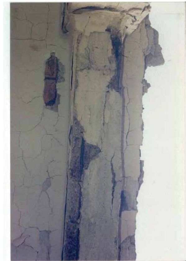
Viga afectada por incendio.
