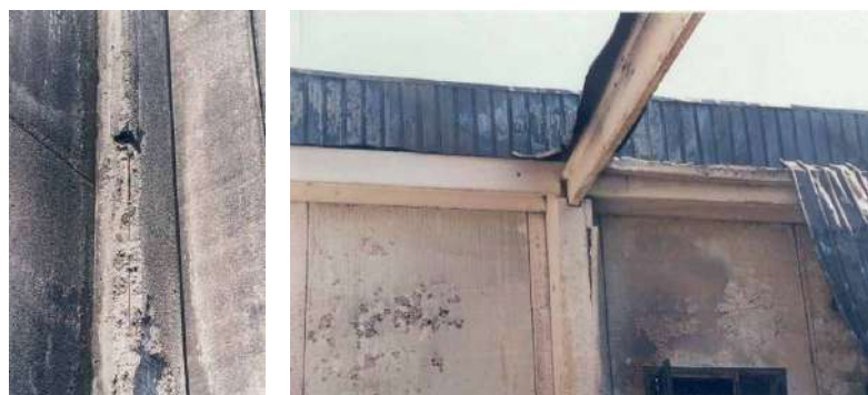
Pilares prefabricados afectados por incendio.
