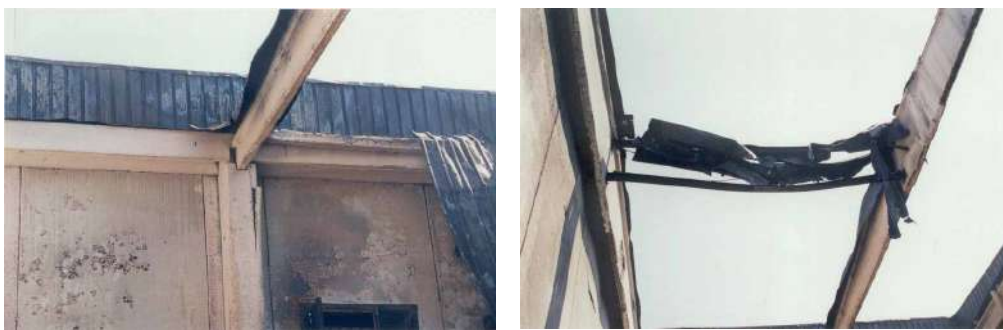
Cubiertas industriales afectadas por incendio.
