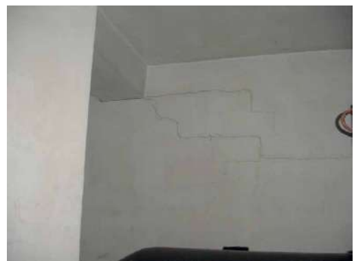
Grietas producidas por el movimiento de la estructura.
