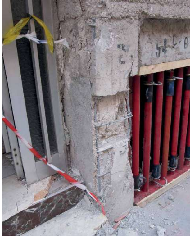
Daños por pilares cortos.
