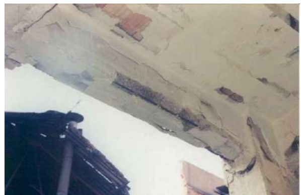
Viga afectada por incendio.
