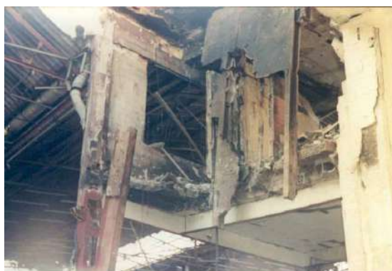
Colapso de forjado.
