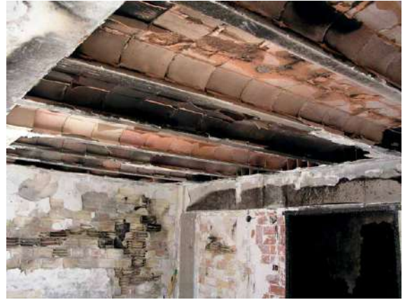
Viga y forjado afectado por incendio.
