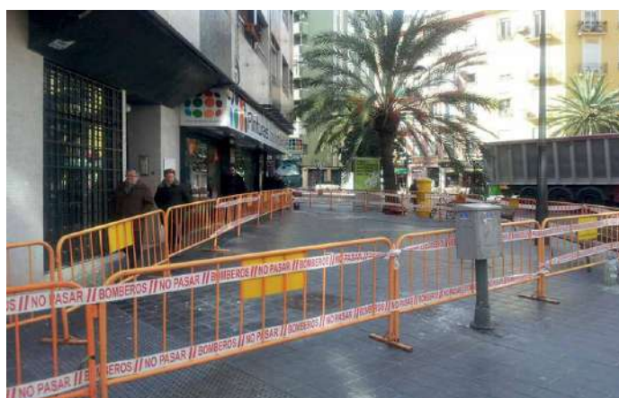
Vallado de zona con riesgo de caída de cascotes.
