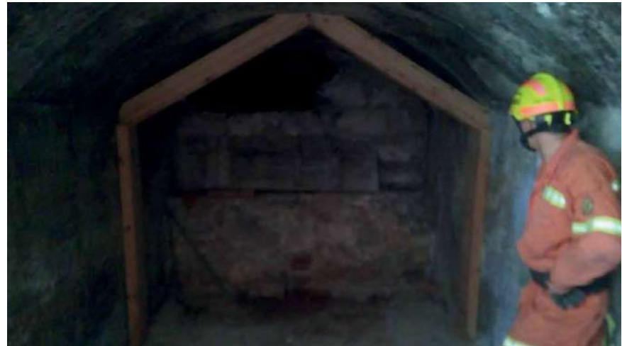
Apeo en Bóveda por lesión en Clave. Autores.
