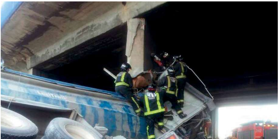
Disgregación por impacto.
