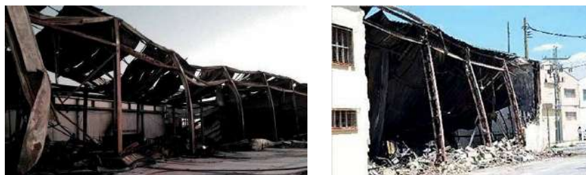
Estructuras con nudos rígidos deformadas hacia el interior.
