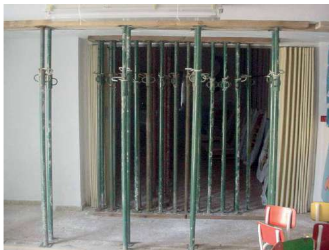
Apuntalamiento por rotura de pilar a compresión.
