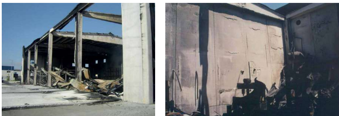
Placas de revestimiento afectadas por incendio.
