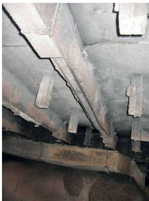
Armaduras al descubierto afectadas.
