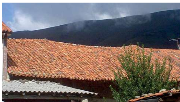
Deformación de viga cumbre.
