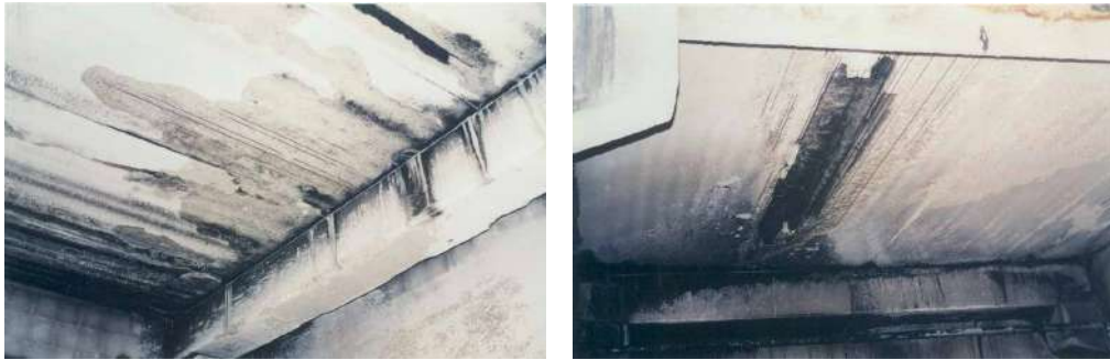
Losas alveolares afectadas por incendio.
