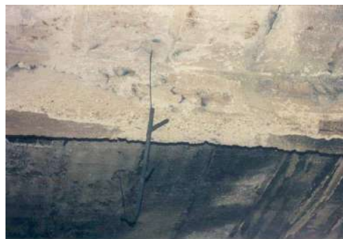
Viga y forjado afectado por incendio.
