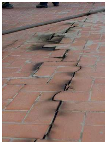
Forjado . afectado por incendio.
