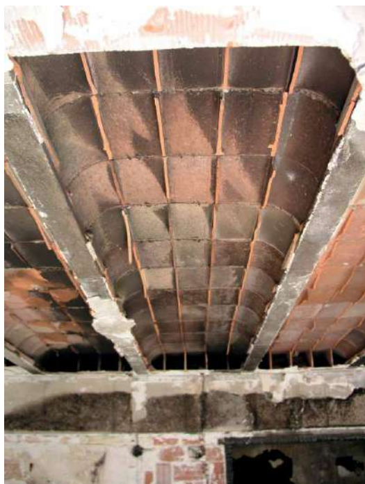
Forjado afectado por incendio.
