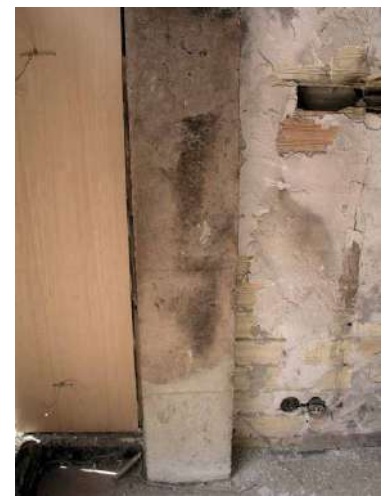
Pilar afectado por incendio.
