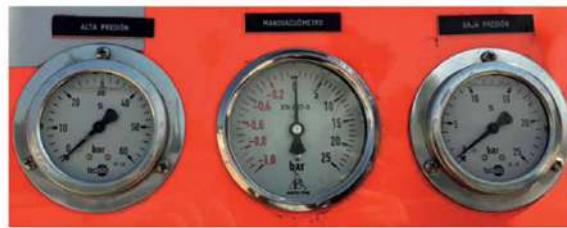
Manómetro de alta presión, manovacúmetro y manómetro de baja.
