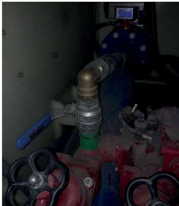
Válvula de llenado de cisterna, sifón o bypass.
