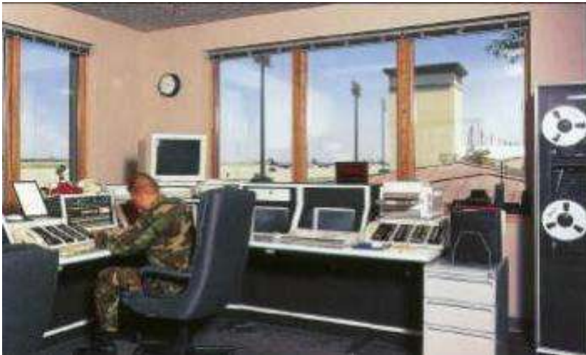
Imagen 19 Cabina o centro de comunicaciones
