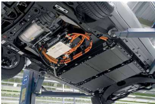
Cableado naranja en los bajos.
