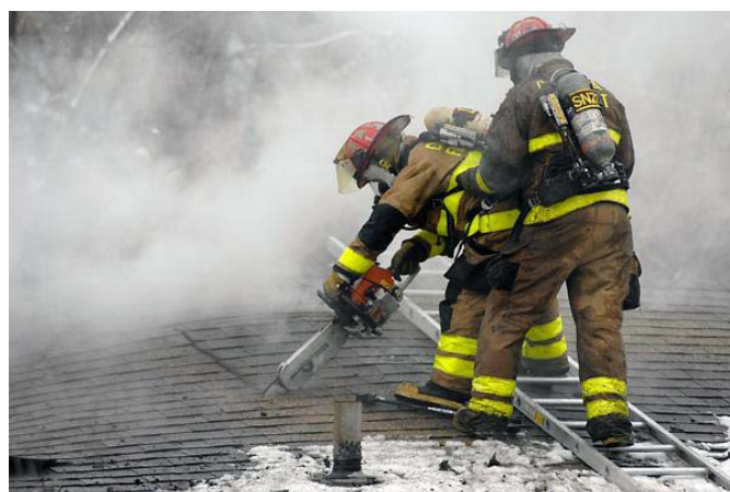
Imagen 108. Ventilación natural en cubierta.
