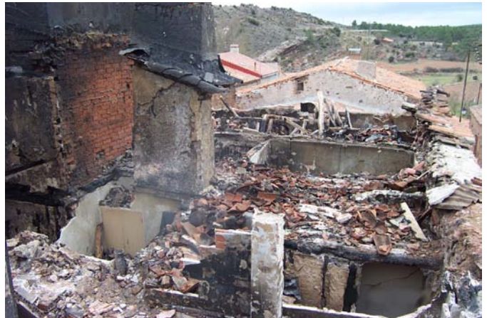
Imagen 36. Incendio de continente y contenido en estructura tradicional cubierta de madera.
