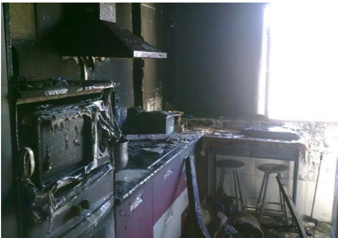
Imagen 35. Incendio de contenido. Estructura de obra de fábrica y forjados de hormigón.
