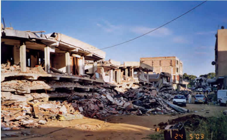
Figura 5. Estructura colapsada. Argelia 2003
