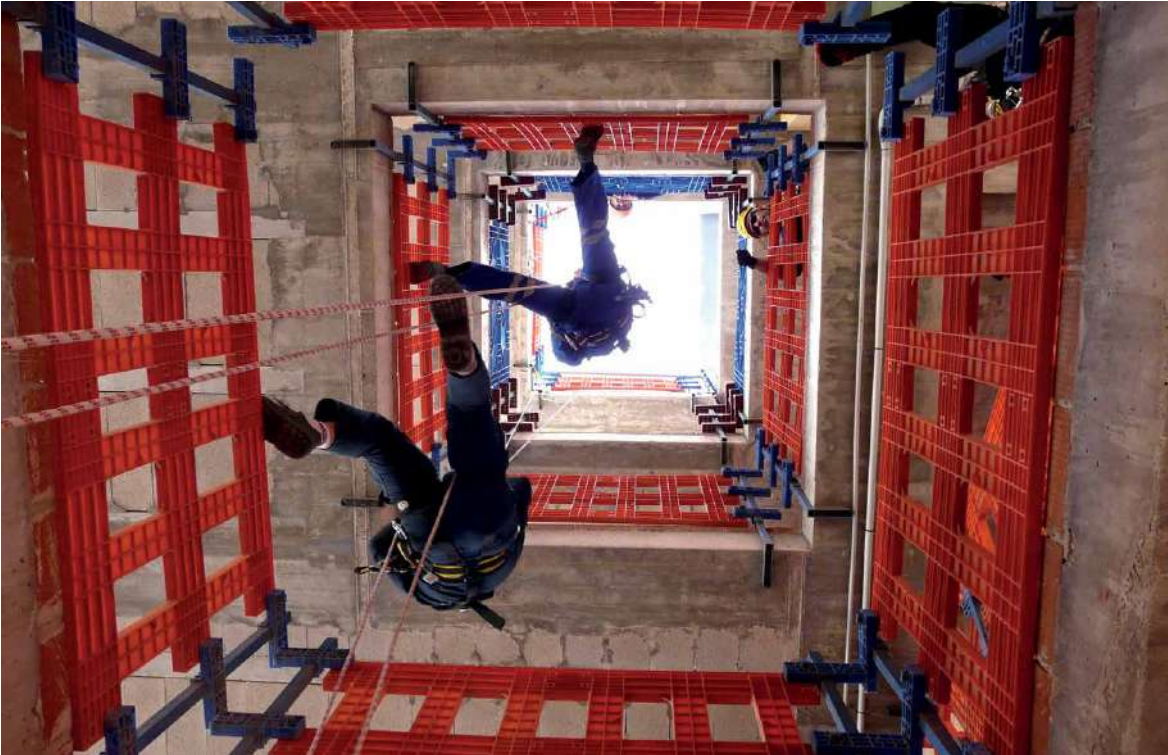
Vallado en zonas con riesgo de caída.
