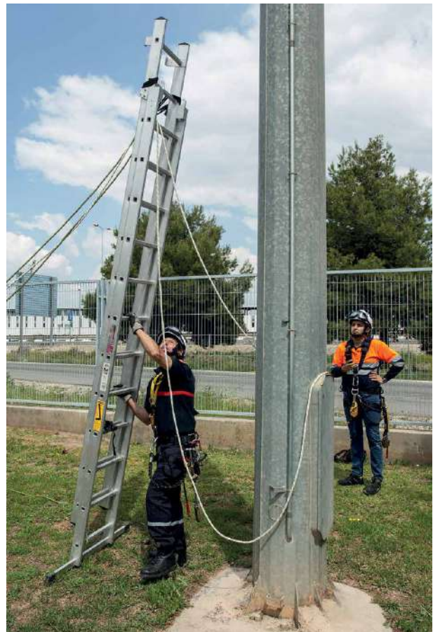
Anclaje de escalera a poste y sistema anticaídas desembragable.
