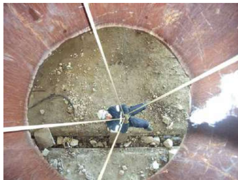
Anclajes de fortuna.
