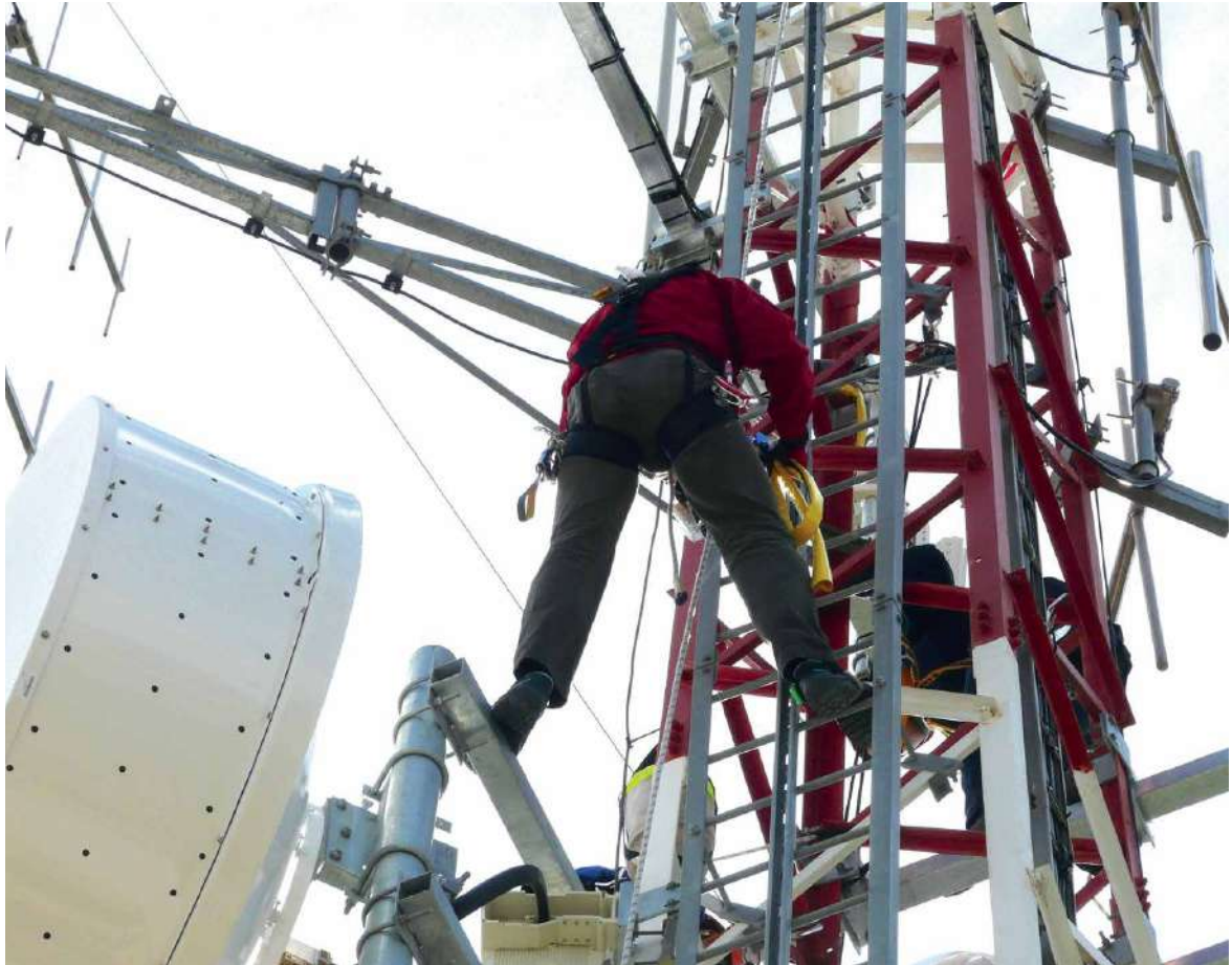
Sistema anticaídas en escalera fija.
