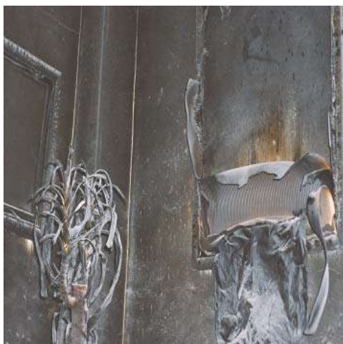
Figura 3 Después de un flashover
