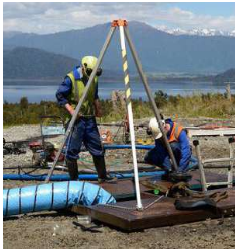
Figura 55. Ejemplo de vigía, inyección de aire en un pozo de petróleo abandonado (...) antes de enviar trabajadores a un espacio confinado
