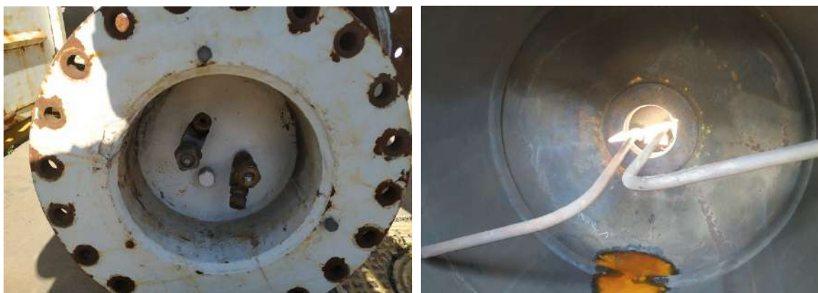
Válvulas y tubos buzo interiores del bidón a presión de cloro Fuente.: M.Albaladejo
