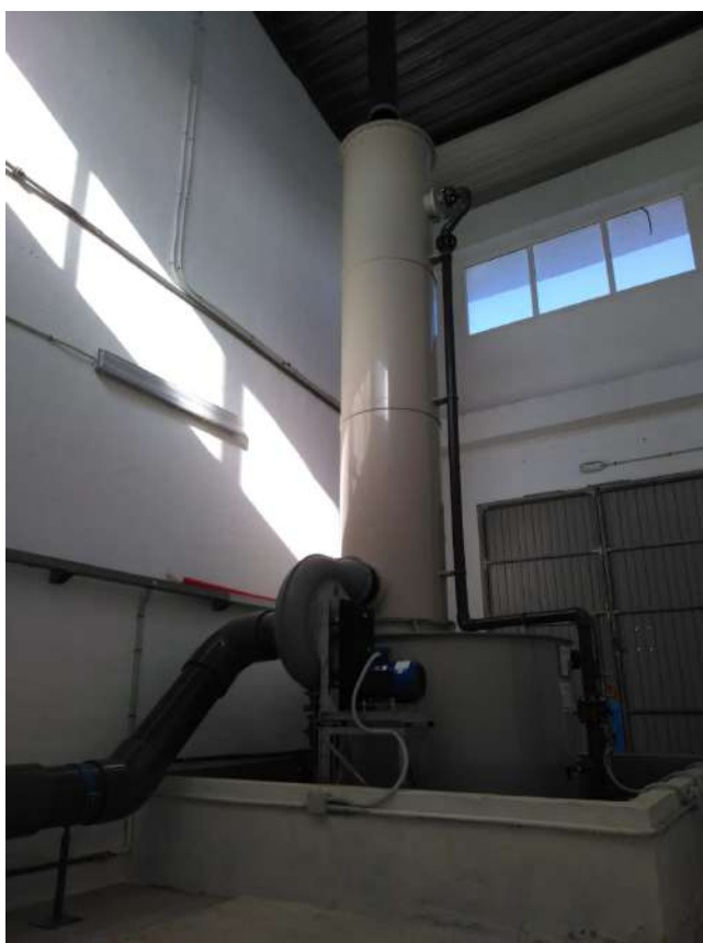
Scrubber para el lavado de gases.
