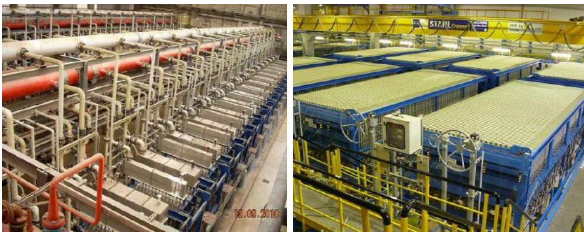
Dispositivo de celdas de membrana – monopolar (izda) – bipolar (dcha) Fuente: Solvay 2010 (izda), Vinnoli 2011 (cha)
